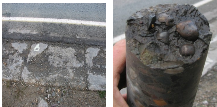
Рис.1 Деструктуризация (разрушение) бетона изделий поверхностного водоотвода
